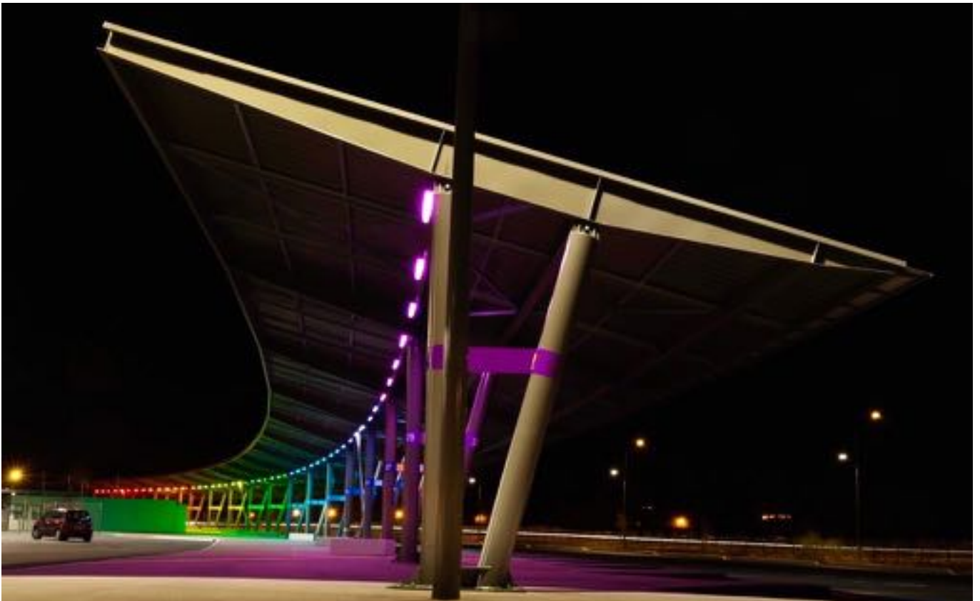
Ombrière photovoltaïque éclairée (2013)
